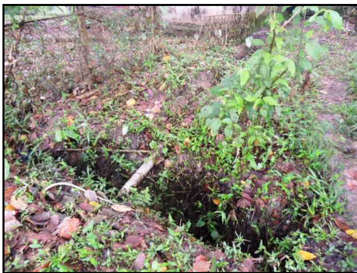
Figura 07 – Esgoto direcionado à fenda gerada em abatimento de solo.
