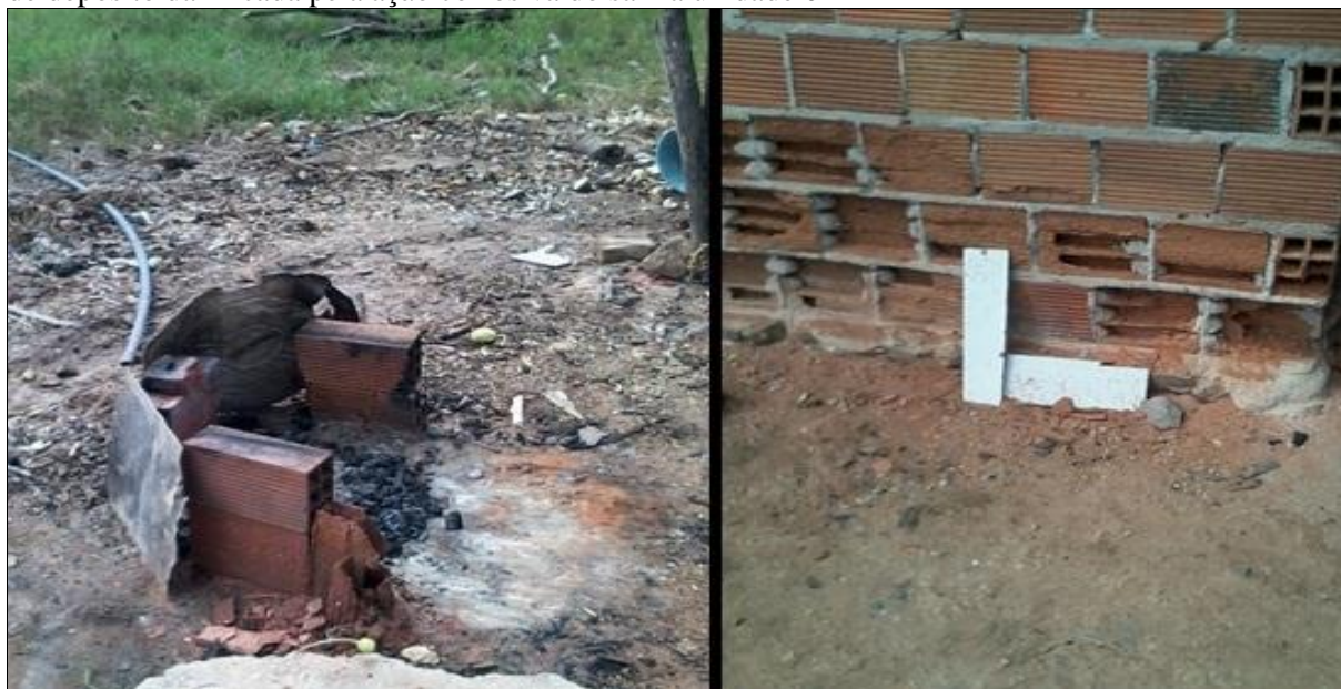
Figura 02: À esquerda, modelo de fogão utilizado no beneficiamento do amendoim e à direita parede de depósito danificada pela ação corrosiva do sal na unidade 01
