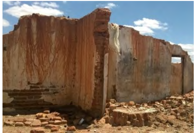
Figura 19 - Casa em ruína no Sítio Melancia.
