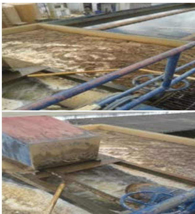
Figuras 4 e 5: Estado da água sem tratamento
